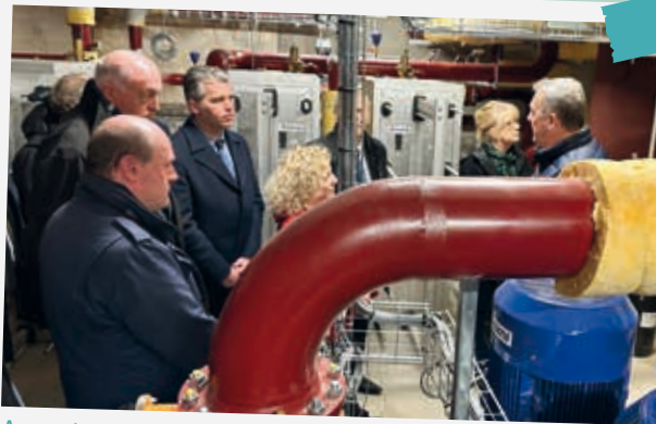
Aquarives est désormais relié au réseau de chaleur de la Ville d'Hagondange.
